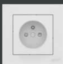
Розетка UPS с защитными шторками
